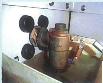
ボールタップ弁の不良で吐水口が 水没している。
