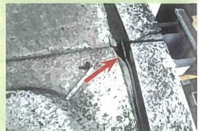
貯水槽本体が変形し、隙間がある。
