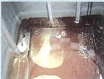
水槽底部に錆が沈殿している。
